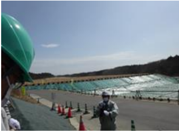
写真3 土壌貯蔵施設（遮水シート上に貯蔵）
