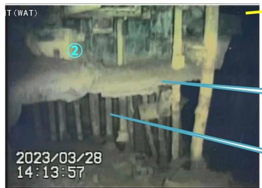
写真2.ペDESTAL開口部左下側壁面部
